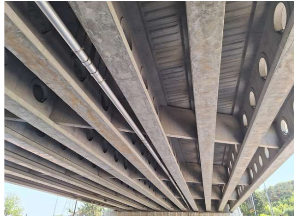
바닥판하면 S1 내측 상태현황
